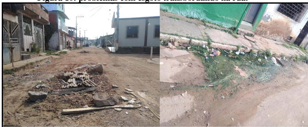
Figura 10: problemas com esgoto transbordando na rua.
